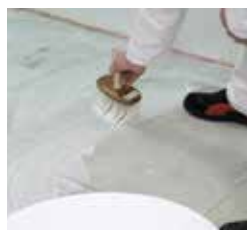
Napenetrujte povrch (Rokogrund profi, Rokolatex plus nebo EP penetrance zasypaná křemičitým pískem)
