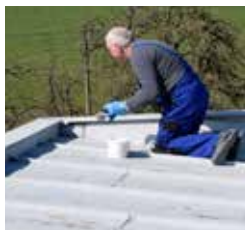
Korozi napadená místa opatřete nátěrem antikoroziní barvy
